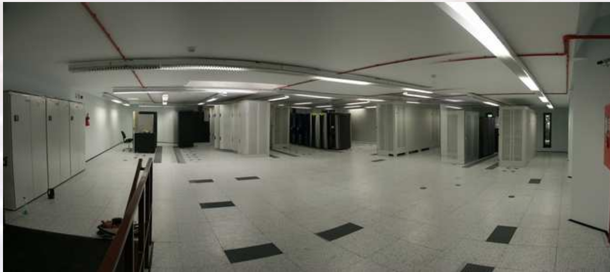
Serwerownia w PCSS
